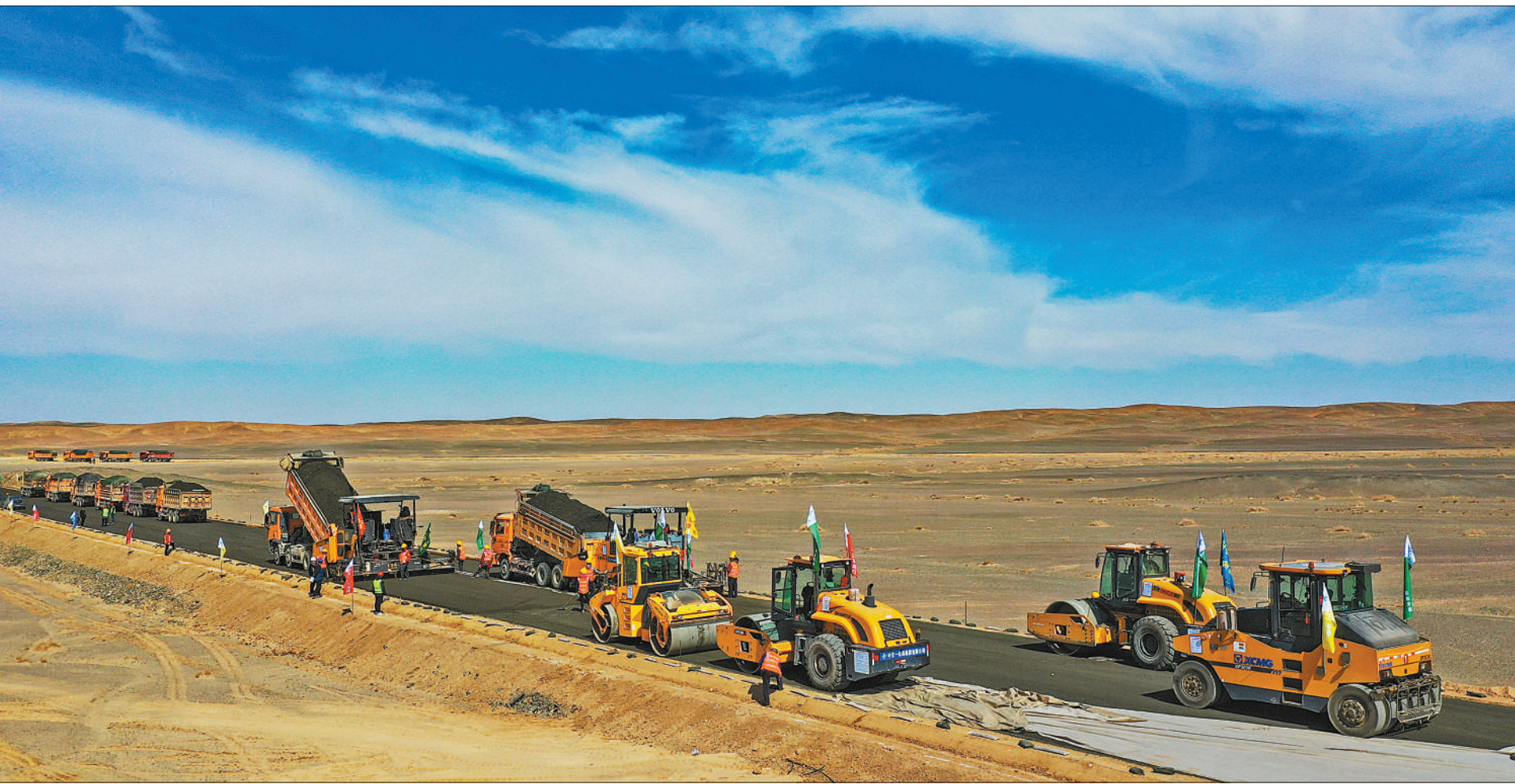
S245线(新疆哈密至甘肃敦煌)公路设计全长186.187公里,预计今年9月底通车。公路建成后,哈密到敦煌的里程将缩短约100公里。图为3月25日,项目建设现场,施工设备正紧张有序地开展作业。
